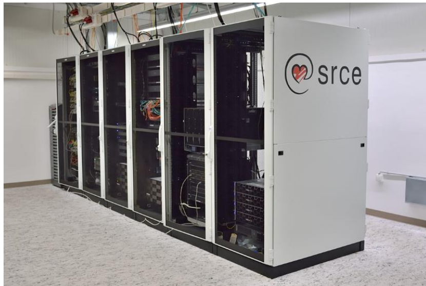
Računalna oprema u podatkovnom centru DC Srce2
