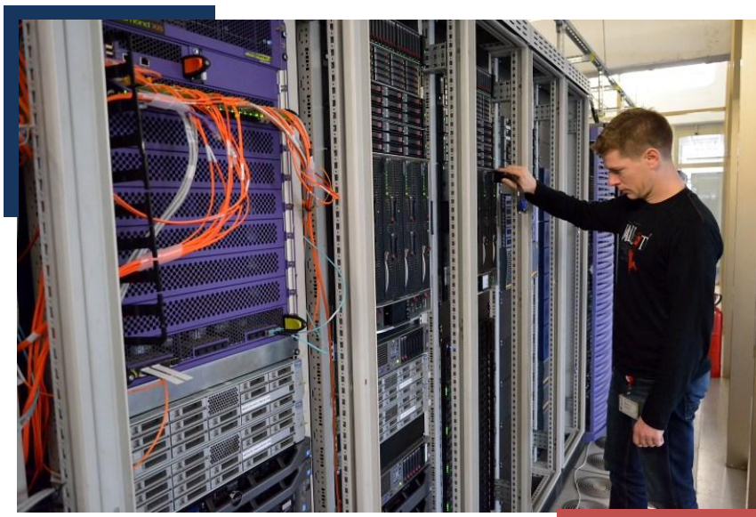
Oprema sustava VPS u računalnoj hali
